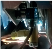
Die Position des Kontrollbrenners
